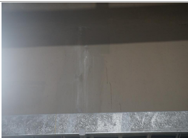
유입밸브실 내부 벽체 백태
