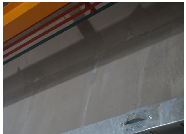
유입밸브실 내부 벽체 백태
