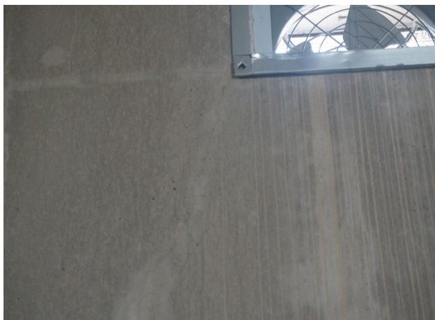
유입밸브실 내부 벽체 균열(0.3mm미만)
