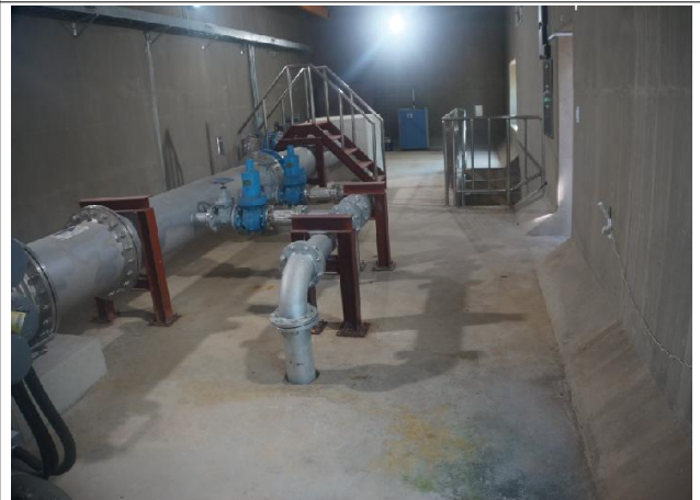
유입밸브실 배관설비 상태양호
