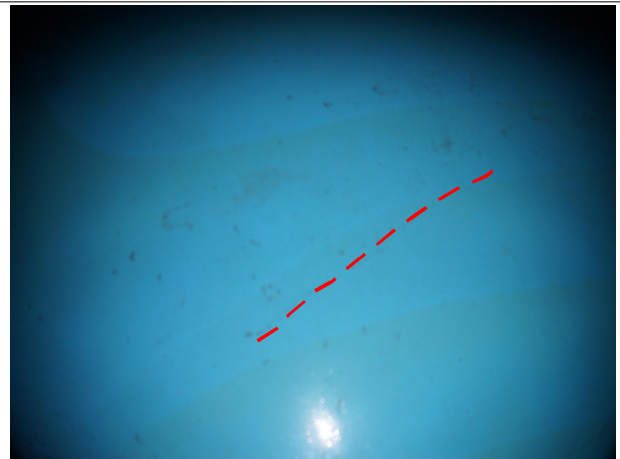
배수지1지 하부슬래브 균열
